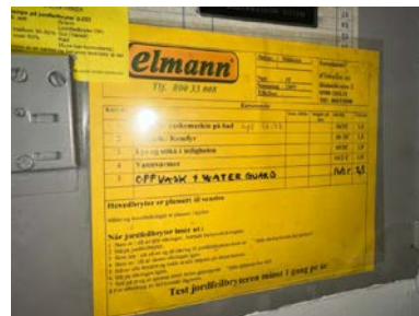
Kursversikt i sikringsskap
