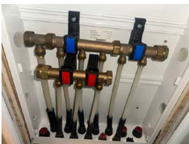
Samleskap med rørkurser
