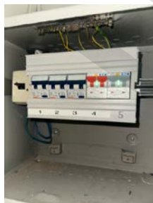
Sikringsskap med automatsikringer.
