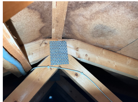
Fuktmerker i toppen
