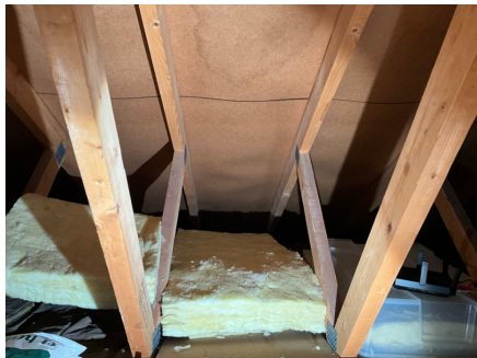
Flere fuktmerker på undertaket.
