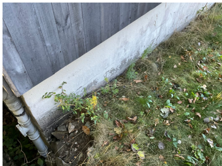
Ingen synlig fuktsperre.
