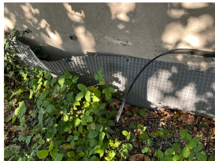
Lokal utbedring anbefales.
