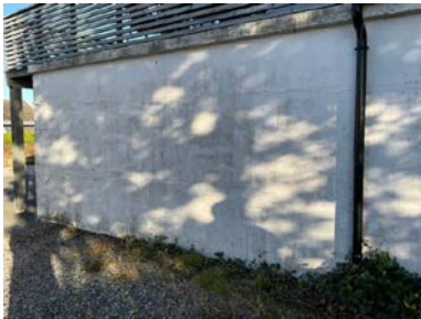
Flere langsgående sprekker.
