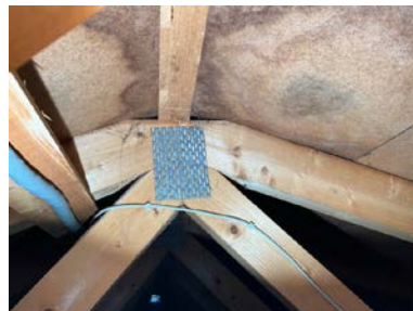
Fuktmerker i toppen
