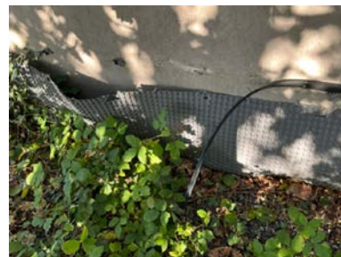
Lokal utbedring anbefales.
