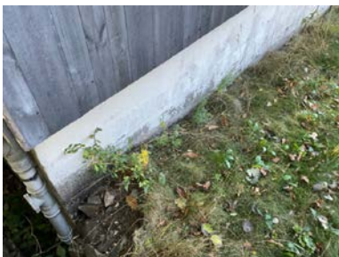
Ingen synlig fuktsperre.
