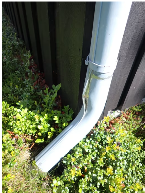
Frostspreng i nedløpsrør.
