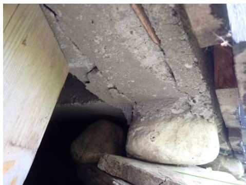
Sprekker/skader i betong oppunder vegg.
