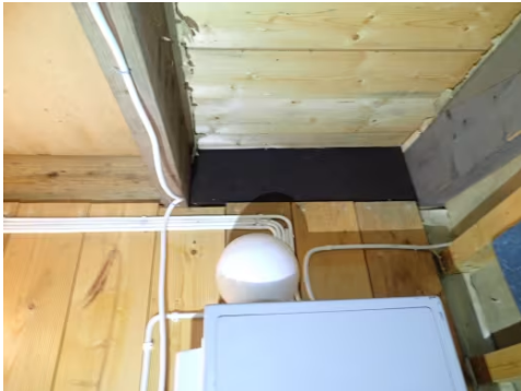
Blokkert lufting / skadet luftepapp.
