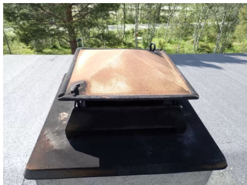
Korrosjon på pipehatt.
