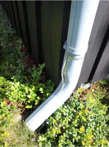
Frostsprenng i nedløpsrør.
