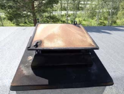
Korrosjon på pipehatt.
