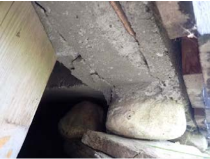
Sprekker/skader i betong oppunder vegg.
