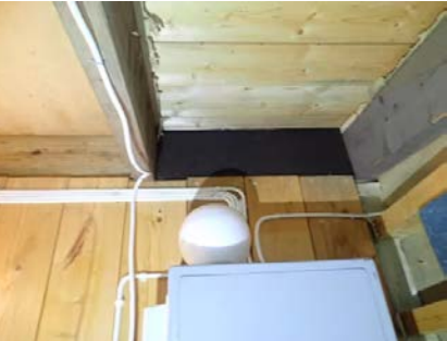
Blokkert lufting / skadet luftepapp.
