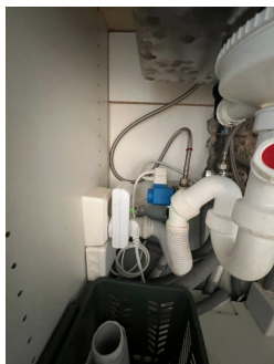
Rørøplegg i kjøkkenbenk med Waterguard
