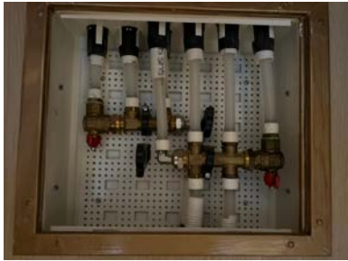
Samleskap med rørkurser og stoppekraner
