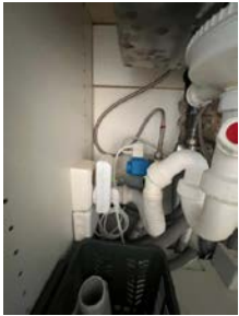
Rørøpplagg i kjøkkenbenk med Waterguard
