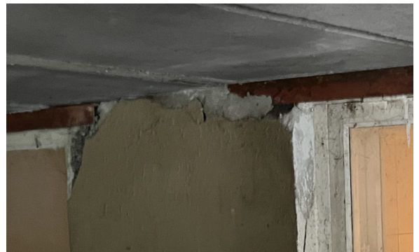
Avskalling i mur, rust på bjelke.
