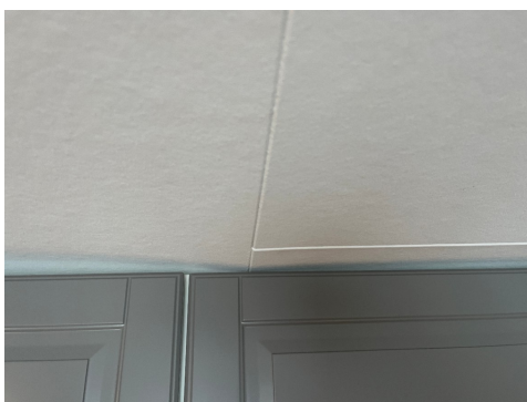
Fukt/svelleskader i tak over kjøkken.
