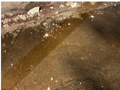
Fukt på gulv i kjeller.
