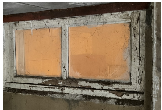
Råteskade i vindu
