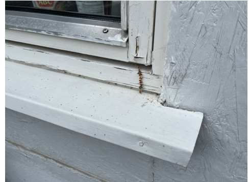
Værslitt, oppsprukket maling.
