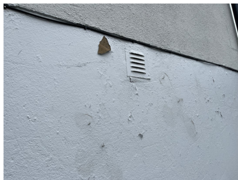
Fluss i overflater murvegg.
