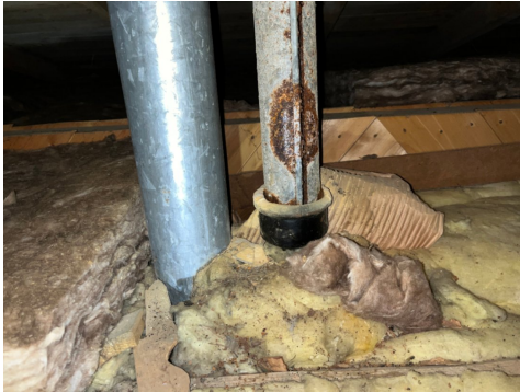
Sprekk i lufterør og manglende isolering
