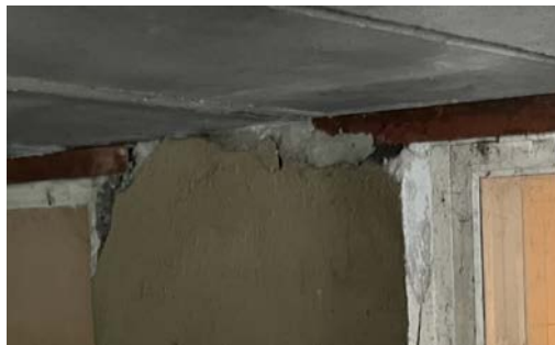
Avskalling i mur, rust på bjelke.
