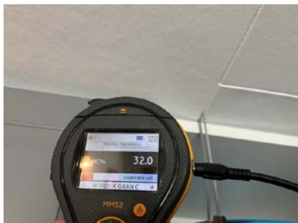
Vann/fuktighet i tak under bad
