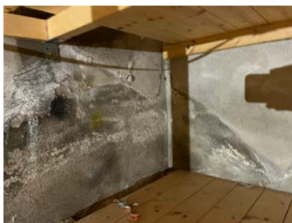
Saltutslag på vegger
