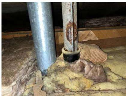
Sprekk i lufteør og manglende isolering
