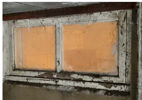
Råteskade i vindu
