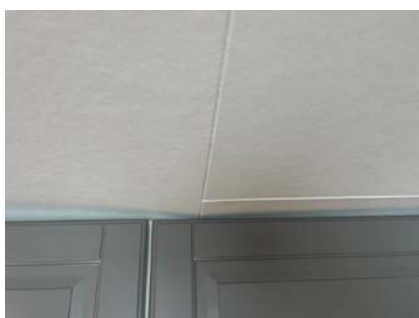
Fukt/svelleskader i tak over kjøkken.
