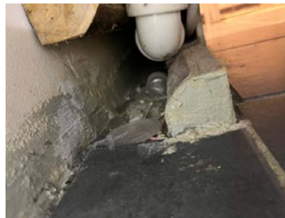
Manglende tetting av kasse til rør.
