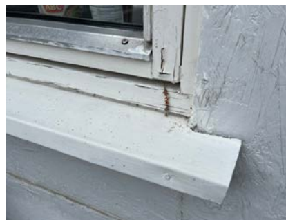
Værslitt, oppsprukket maling.
