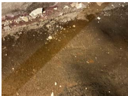
Fukt på gulv i kjeller.
