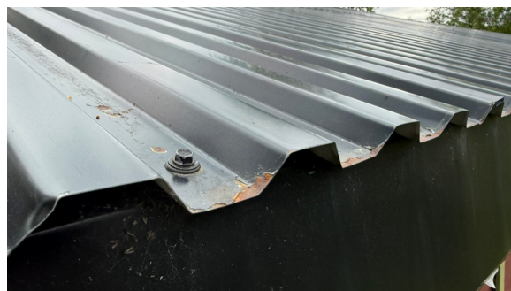
Eksempel på rustdannelse på takplater
