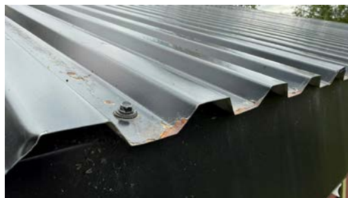
Eksempel på rustdannelse på takplater
