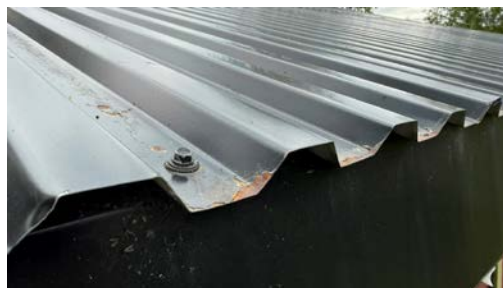
Eksempel på rustdannelse på takplater
