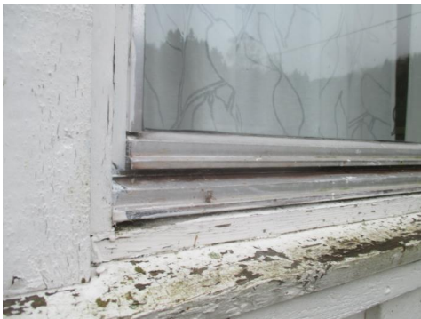
En del vedlikehold må beregnes på eldre vinduer.
