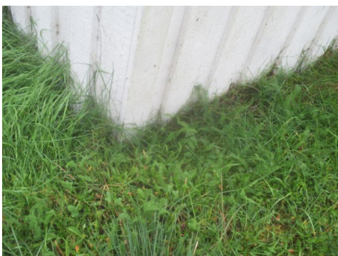
Kledning nær bakkenivå enkelte steder.
