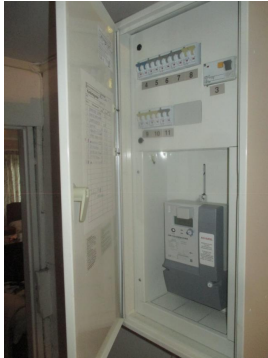
Nyere sikringskapp i gangen på loftet.
