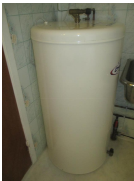
Bereder er plassert på bad/vaskerom.
