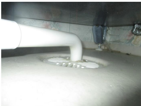
Sluk under dusjkabinett.
