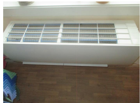
Varmepumpe i stue.
