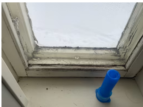
Bilde av vindu på bad som viser malingsavskalling.
