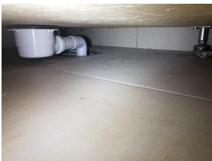
Avløpsrør (ink. sluk) - [Sluk under dusjkabinett bad 1.etg ]
