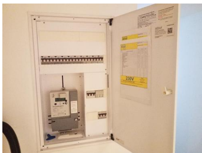
Elektrisk anlegg - [El.tavle i underetasje ]
