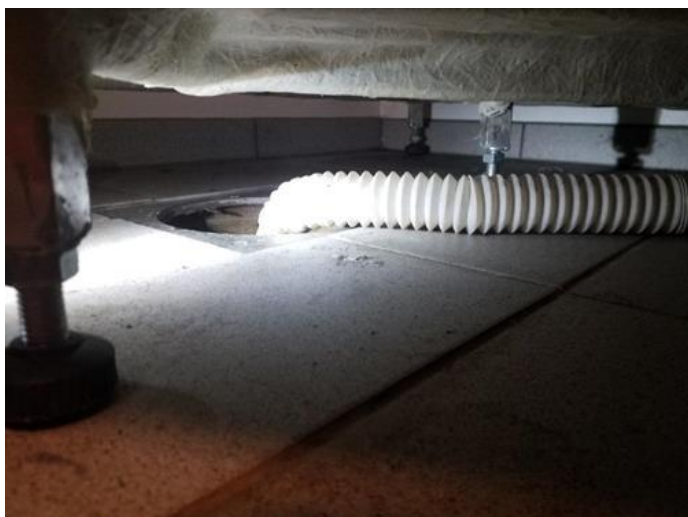
Avløpsrør (ink. sluk) - [Sluk under dusjkabinett bad/vaskerom underetasje ]
