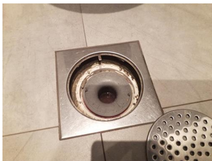
Avløpsrør (ink. sluk) - [Sluk vaskerom 1.etg ]
