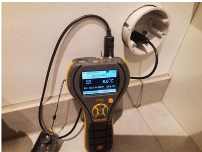
Fukt i tilliggende konstruksjoner - [Fuktmåling vaskerom 1.etg ]
