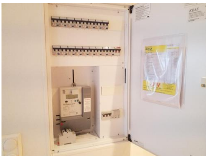
Elektrisk anlegg - [El.tavle montert 1.etg ]
