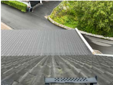
Mangler snøfanger på baksiden.
