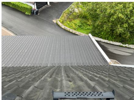
Mangler snøfanger på baksiden.
