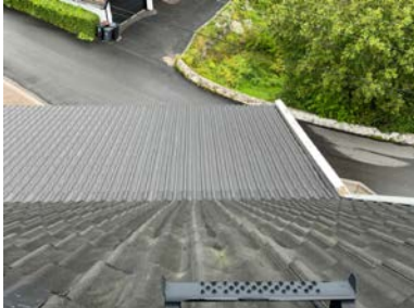
Mangler snøfanger på baksiden.
