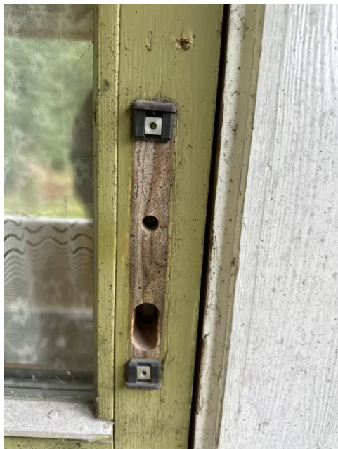
Mangler dørrider på balkongdør.
