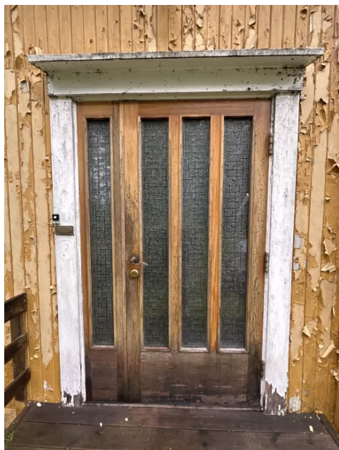
Ytterdør med slitasje og utsatt for fuktighet.
