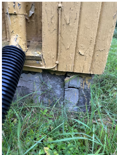
Sprekker i grunnmur.
