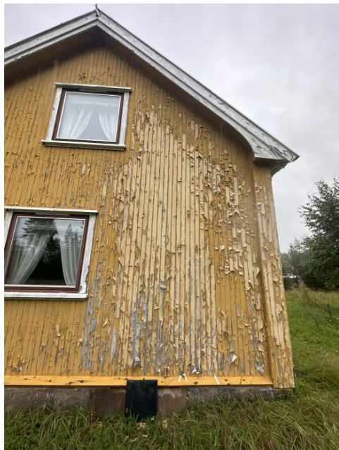
Kledning med behov for vedlikehold.
