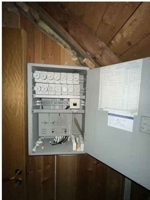
Viser sikringsskap med skrusikringer plassert i 2.etasje
