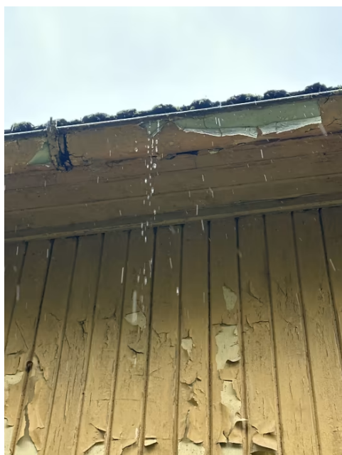
Påvist lekkasje i takrenne.
