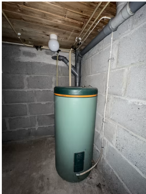
Viser vann og avløpsrør i kjeller.
