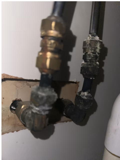
Viser irr på eldre vanninstallasjoner.
