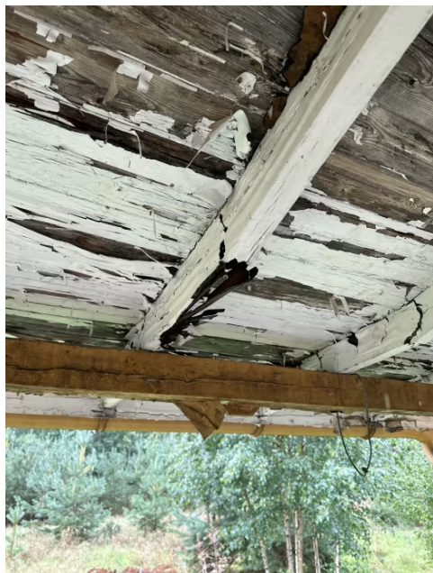
Store råteskader i takkonstruksjon. Ny takkonstruksjon må etableres.
