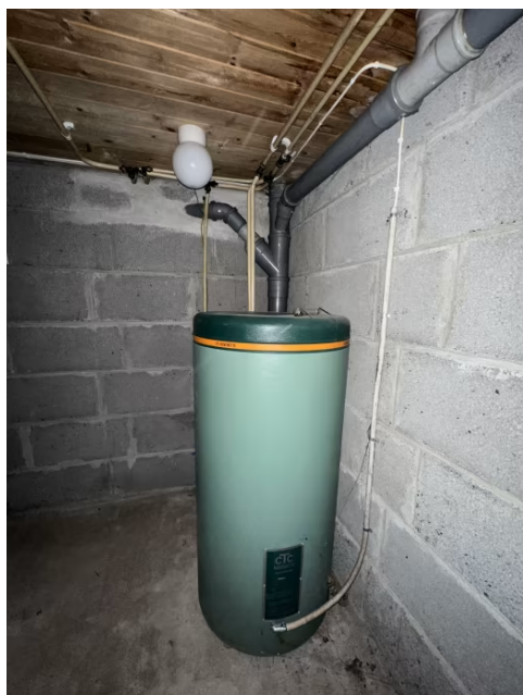
Viser bereder plassert i kjeller.
