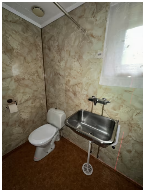
Eier opplyser om lekkasje fra toalett.
