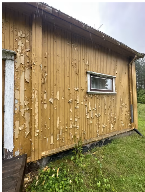
Viser kledning med svertesopp og malingsavflassing.
