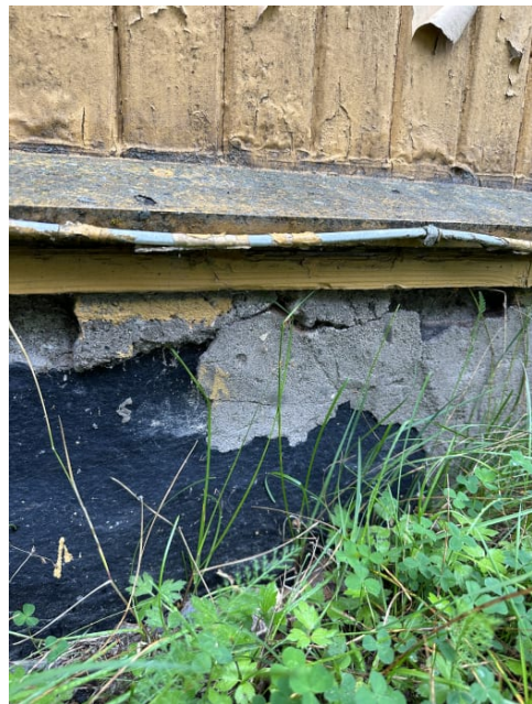
Sprekker i grunnmur.
