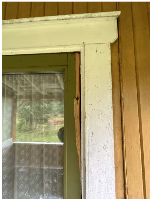
Dør skadet på grunn av innbrudd.
