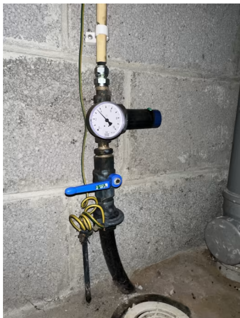
Vanninntak og hovedstoppekran i kjeller.
