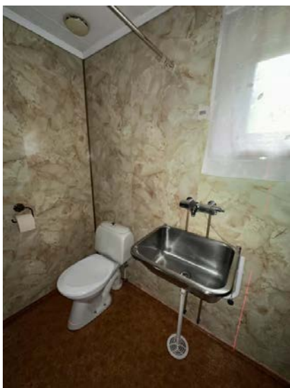
Eier opplyser om lekkasje fra toalett.
