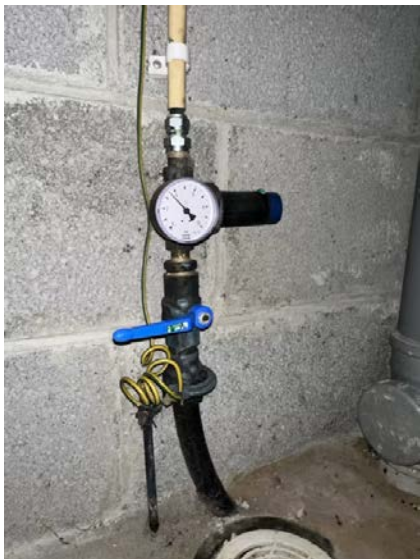
Vanninntak og hovedstoppekran i kjeller.
