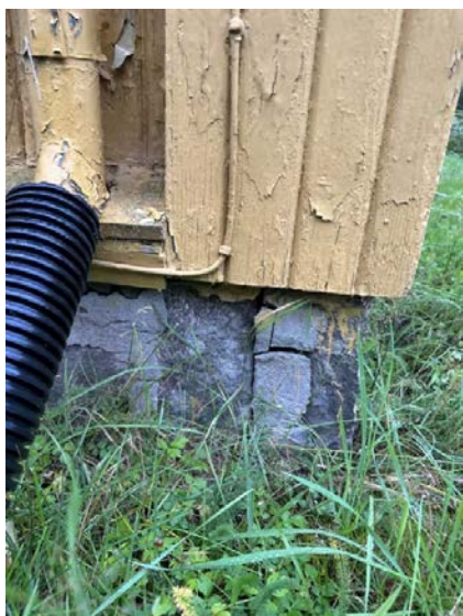
Sprekker i grunnmur.
