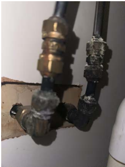
Viser irr på eldre vanninstallasjoner.
