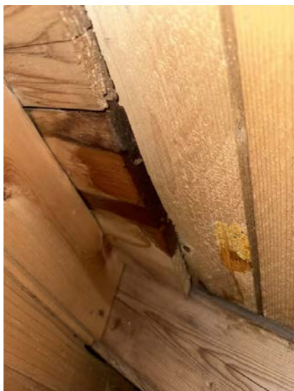
Taket er ikke tett vann.
