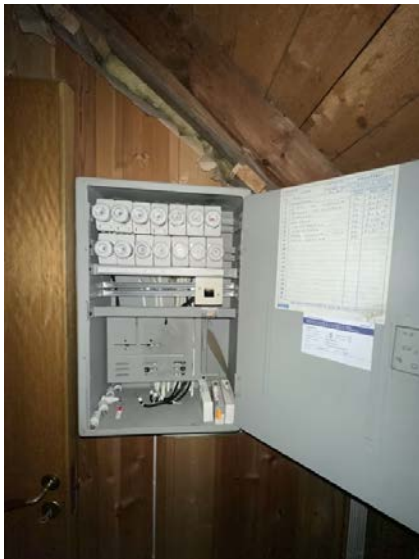
Viser sikringsskap med skrusikringer plassert i 2.etasje
