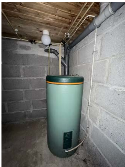
Viser vann og avløpsrør i kjeller.
