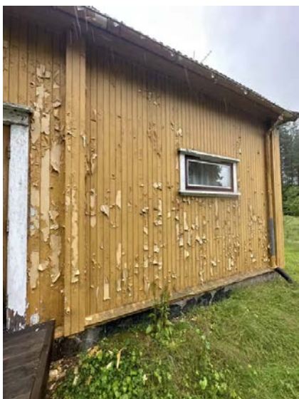
Viser kledning med svertesopp og malingsavflassing.
