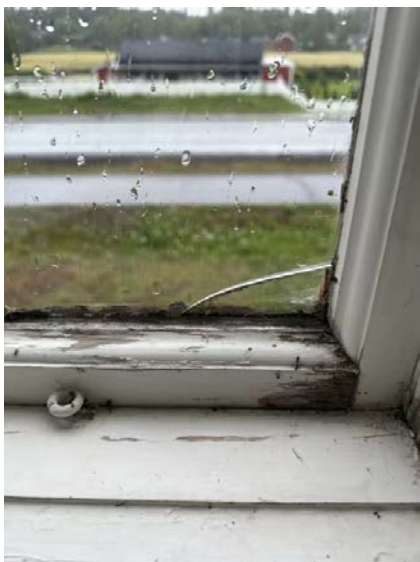
Viser kondensskader og sprekk i glass på vindu (soverom i 2.etasje).
