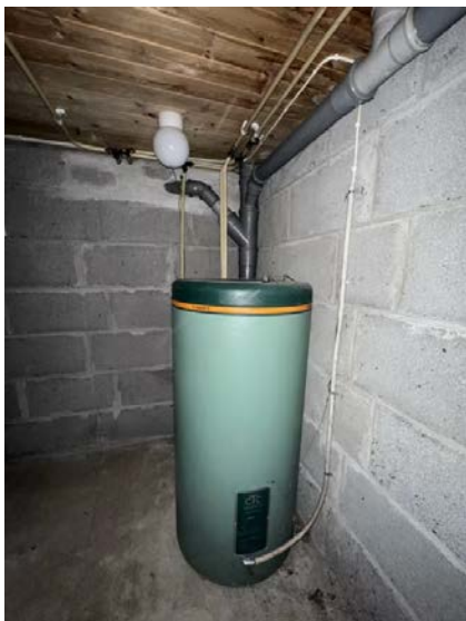
Viser bereder plassert i kjeller.
