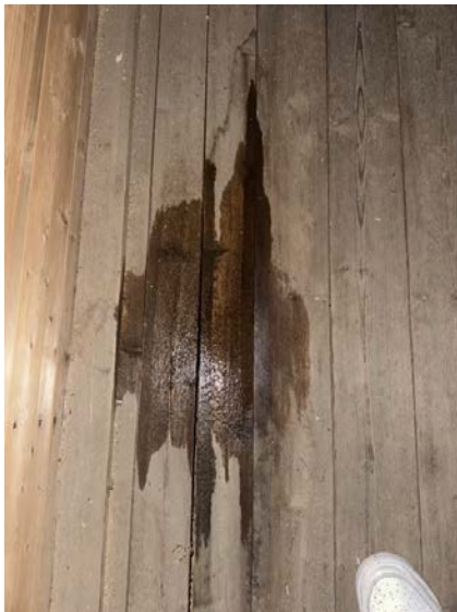
Vann drypper ned fra undertak og på gulvkonstruksjon i raftekott.
