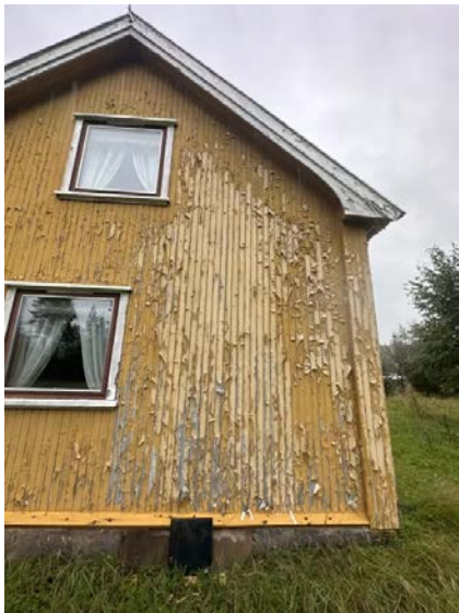
Kledning med behov for vedlikehold.
