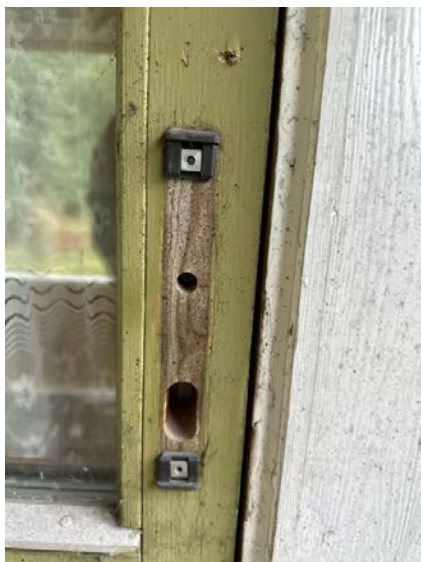
Mangler dørvrider på balkongdør.
