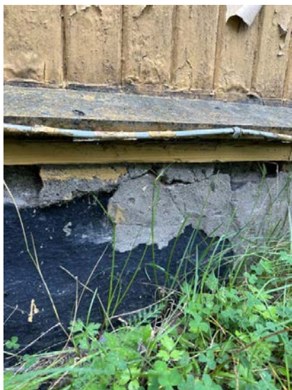
Sprekker i grunnmur.
