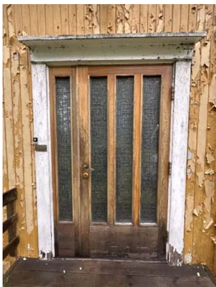
Ytterdør med slitasje og utsatt for fuktighet.
