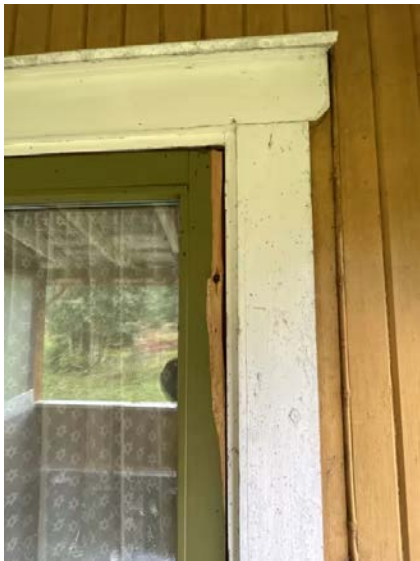
Dør skadet på grunn av innbrudd.
