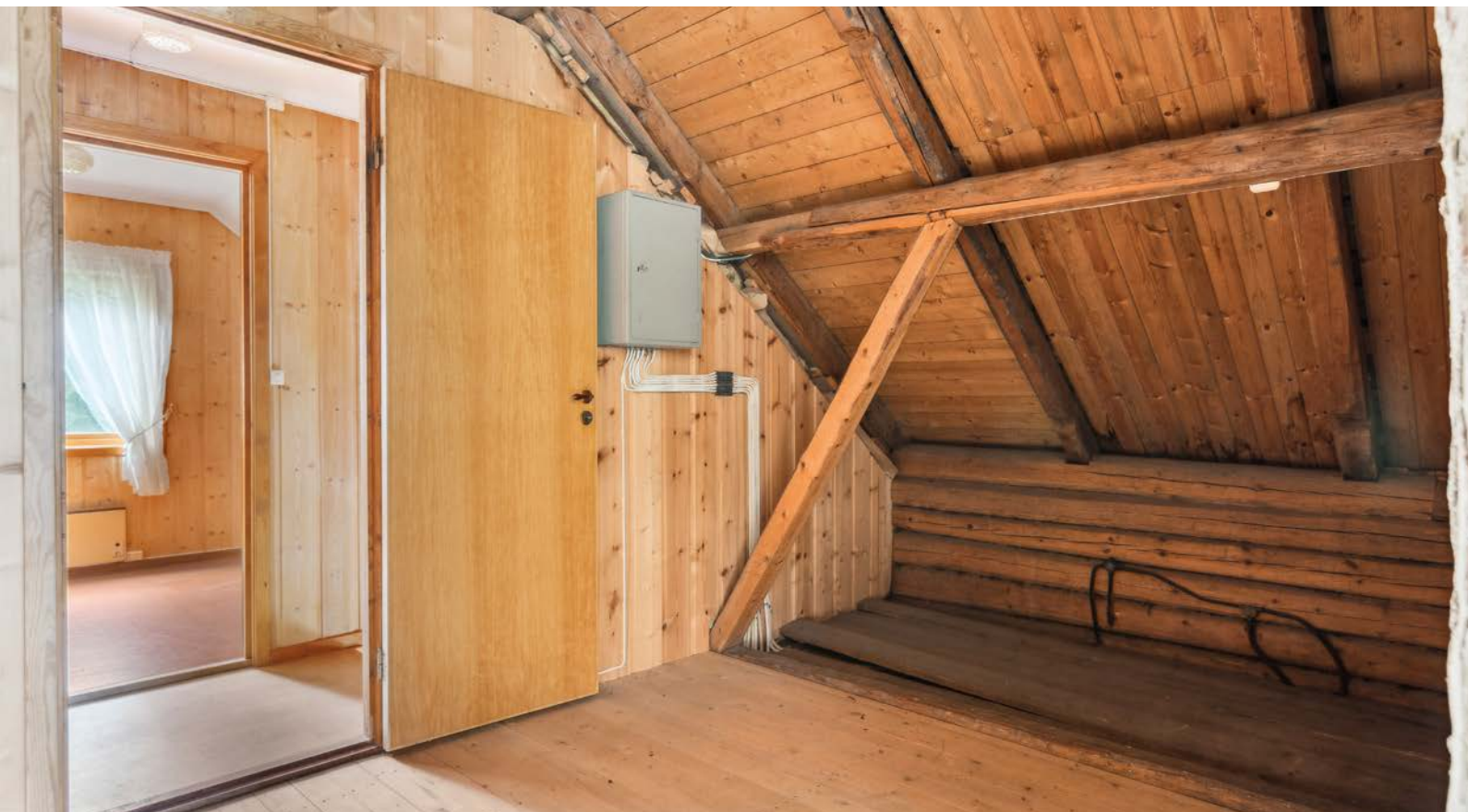
Sikringsskap med skrusikringer. Elvia AS opplyser om at det p.t. ikke er strøm på dette anlegget. Måler ble tatt ned 01.06.2021.
