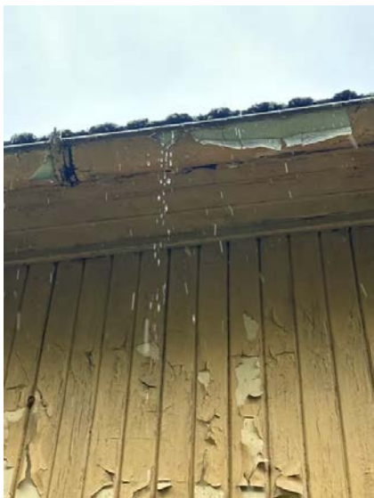
Påvist lekkasje i takrenne.
