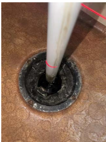
Sluk under skyllekar, rust på skruer i sluk.
