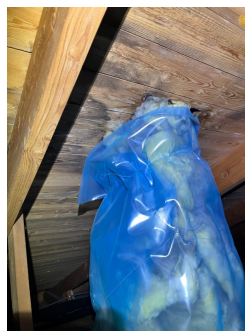
Eldre fuktmerker ved tak gjennomføring for kloakklufting
