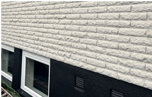
Mangler drenerings åpninger
