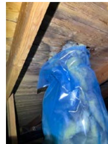
Eldre fuktmerker ved tak gjennomføring for kloakklufting
