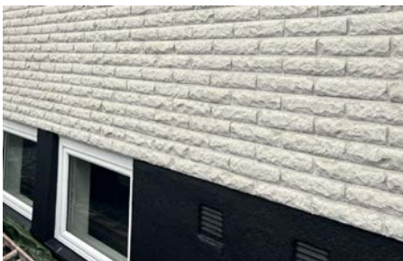
Mangler drenerings åpninger
