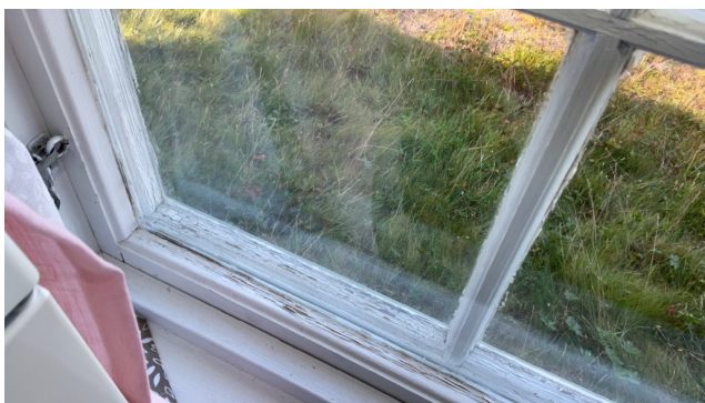
Vinduer er preget av elde og slitasje
