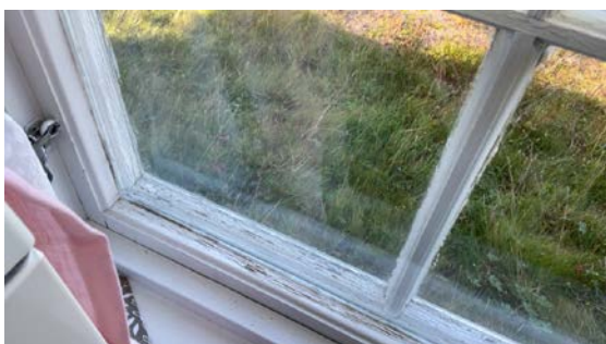
Vinduer er preget av elde og slitasje
