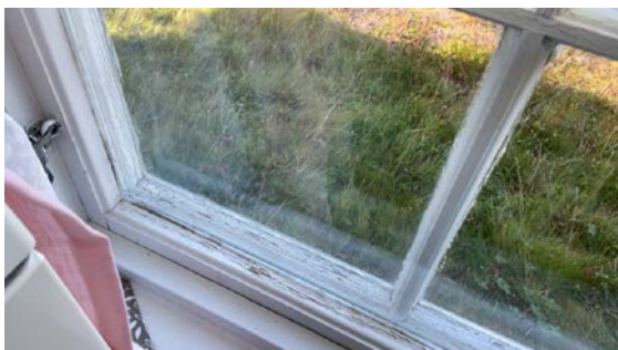
Vinduer er preget av elde og slitasje
