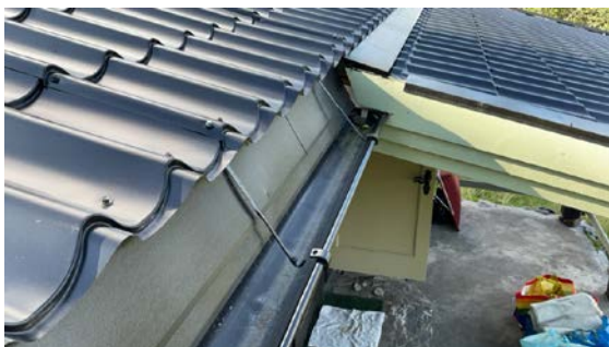
Må monteres snøfanger i gangsonsone
