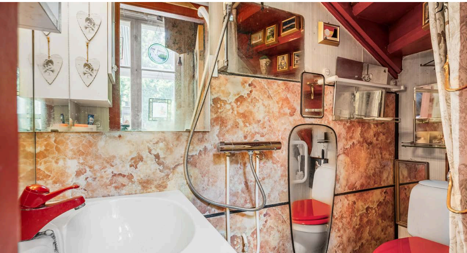
Eldre badet med røde detaljer som er gjennomgående for flere rom. Badet har fått TG3 og må totalrenoveres for å tåle normal bruk etter dagens krav.
