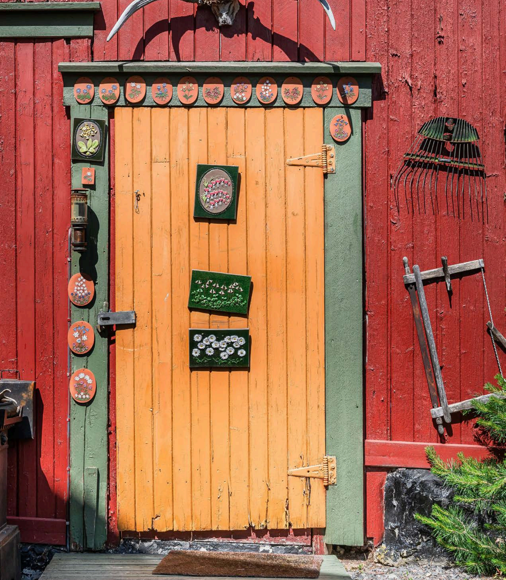
Uthuset har et bruksareal på 16m 2 , men et gulvareal på 21m 2 . Gammelt uthus med preg av manglende vedlikehold.
