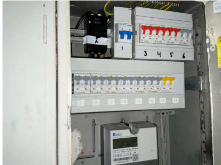
Automatsikringer i sikringsskap plassert i gang/fellesareal.
