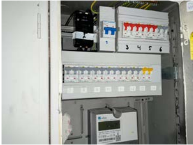
Automatsikringer i sikringskap plassert i gang/fellesareal.
