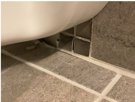
Løse mosaikkfliser under toalett.
