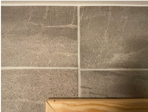
Enkelte skjeve overganger mellom fliser.
