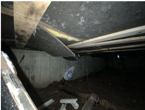
Undertak må utbedres.
