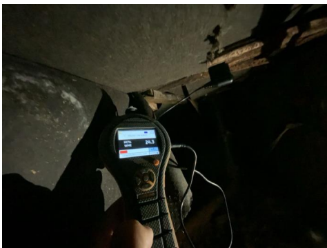
Påvist høy fuktprosent ved målinger på befaringdagen.
