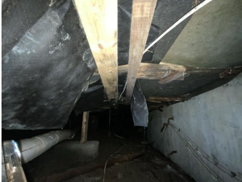
Synlige råteskader på lekter og konstruksjon.
