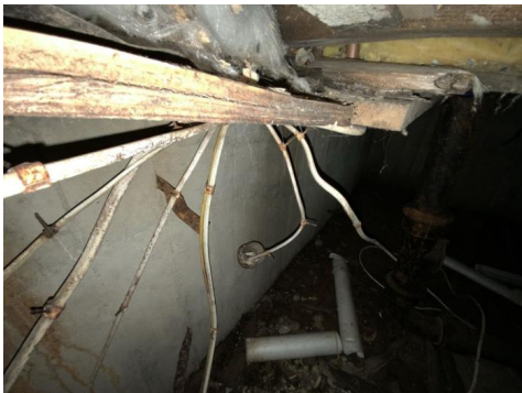
Synlige løse kabler i krypkjeller.
