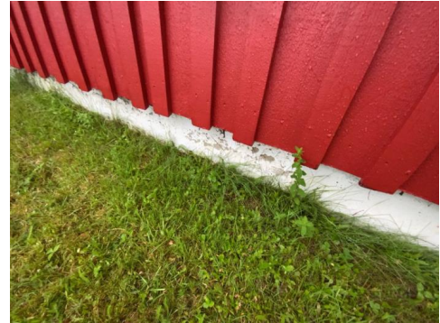
Det er registrert løs puss på muroverflater.
