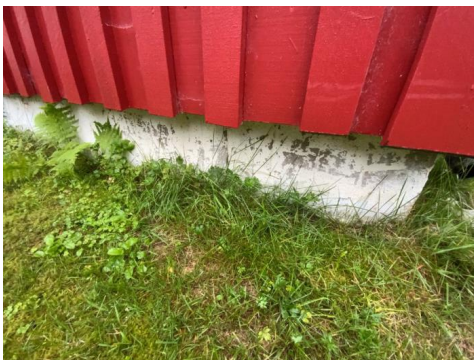
Det er registrert løs puss på muroverflater.
