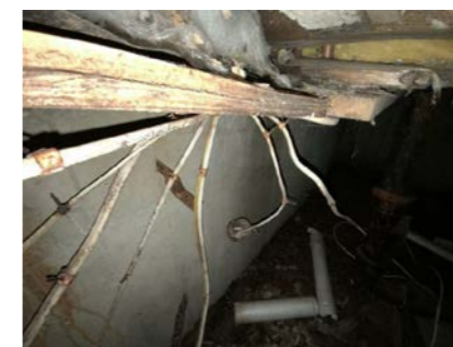
Synlige løse kabler i krypkjeller.
