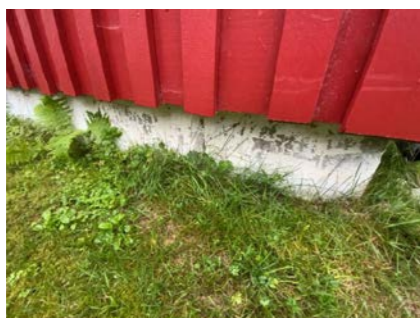
Det er registrert løs puss på muroverflater.
