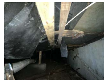
Synlige råteskader på leker og konstruksjon.
