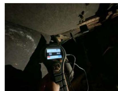
Påvist høy fuktprosent ved målinger på befaringsdagen.
