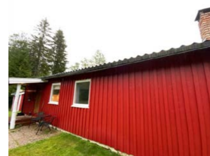
Takrenne i front av boligen har synlig svank og renner over ved nedbør. Kroker og renner bør rettes opp.
