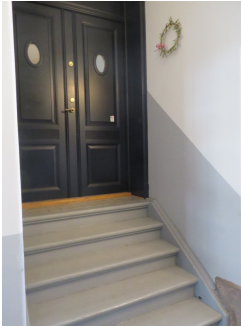
Trapp uten håndløper/rekkverk.
