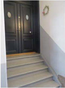
Trapp uten håndløper/rekkverk.
