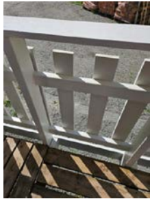
For stor avstand mellom rekkverk og gulv.
