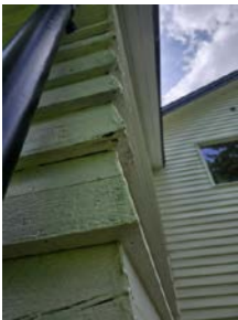
Eksempel på påbegynnende råteangrep.
