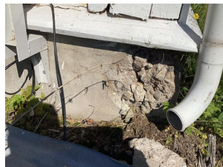
Eksempel på avskaling på grunnmur.
