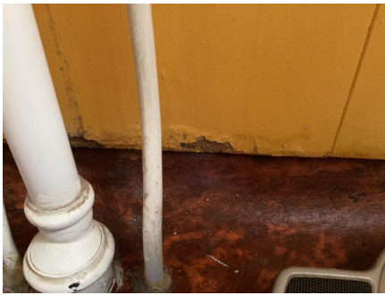
Fuktskade nederst på vegg.
