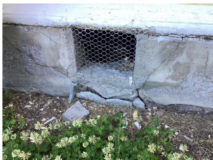
Eksempel på sprekker i grunnmur.
