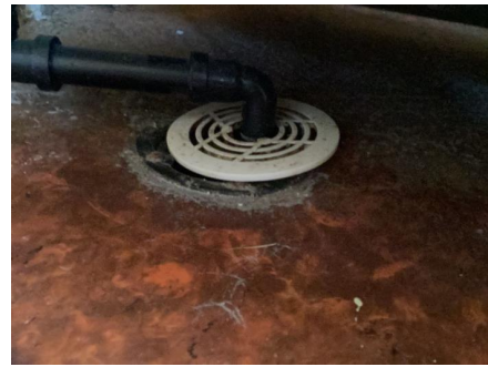
Sluk av plast med klemring.
