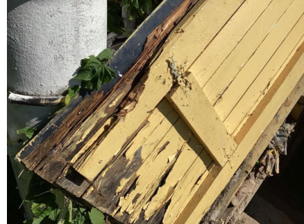
Råteskade på lemmer.
