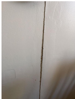
Eksempel på oppsprekking i plateskjøt.
