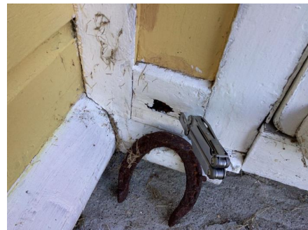
Råte til venstre for kjøkkeninngang.
