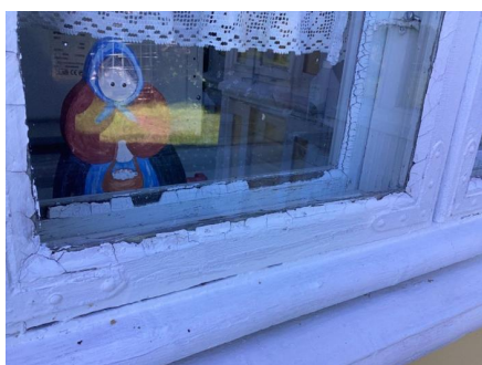
Eksempel på slitasje.
