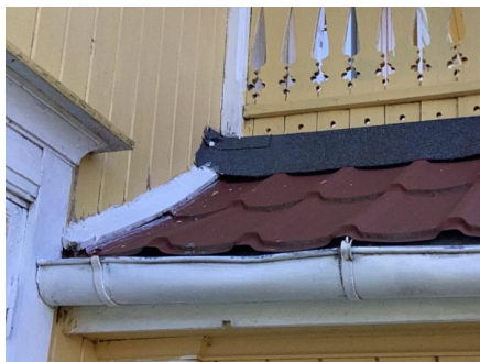
Svai på takkonstruksjonen over kjøkkeninngang.
