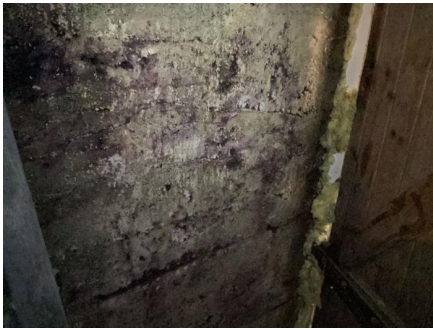
Eksempel på veggoverflate med fuktpåkjenning.
