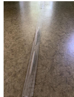
Gulvbelegg på kjøkken løsner i skjøter.
