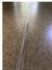
Gulvbelegg på kjøkken løsner i skjøter.
