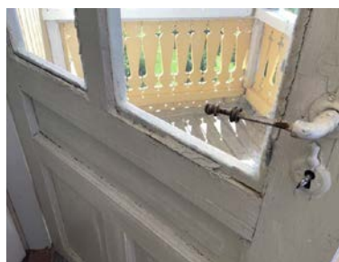
Eksempel på slitasje på balkongdør.
