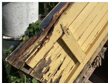
Råteskade på lemmer.
