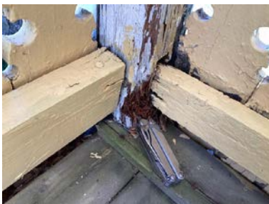
Eksempel på råte i rekkverk.
