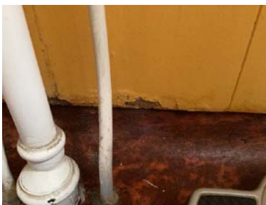
Fuktskade nederst på vegg.
