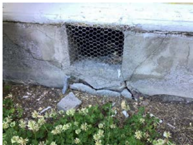
Eksempel på sprekker i grunnmur.
