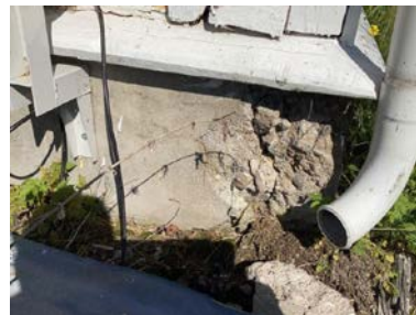
Eksempel på avskaling på grunnmur.
