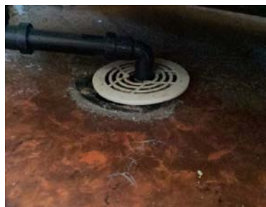
Sluk av plast med klemring.
