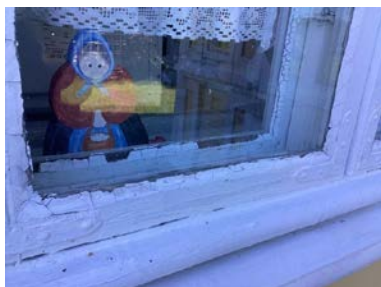
Eksempel på slitasje.
