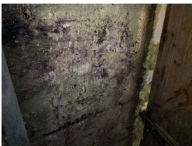
Eksempel på veggoverflate med fuktpåkjenning.
