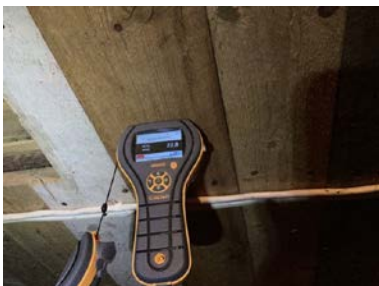
Fuktinnhold i himling på ca. 22 vektprosent.
