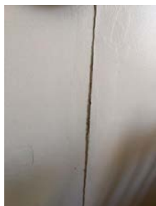
Eksempel på oppsprekking i plateskjøt.
