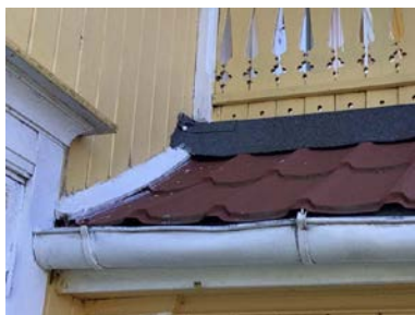
Svai på takkonstruksjonen over kjøkkeninngang.
