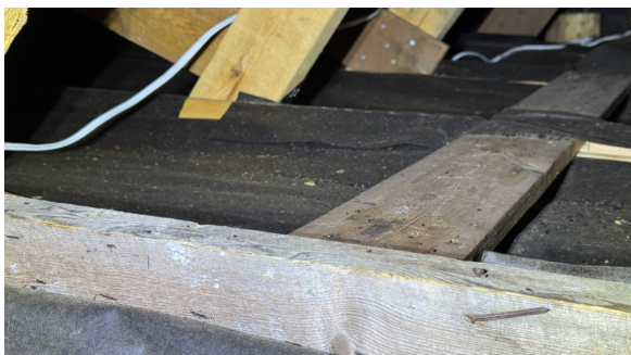
Det er registrert spor etter skadedyr/mus.
