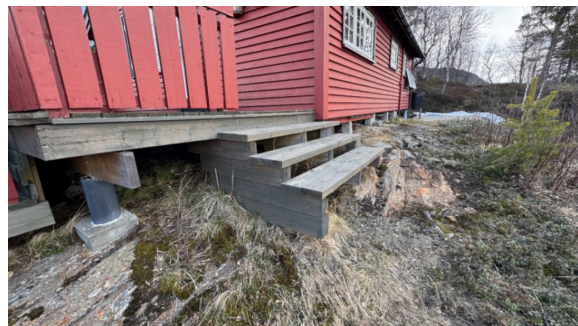
Trapper mangler rekkverk i forhold til forskriftskrav.
