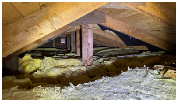
Det er registrert spor etter skadedyr/mus.
