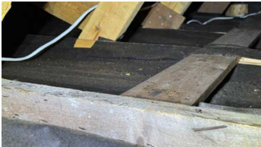
Det er registrert spor etter skadedyr/mus.
