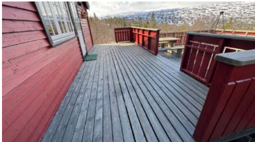
Terrassedekket er noe værslitt.
