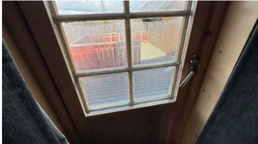
Det er registrert dugg i glasset i srossene på terrassedøren.
