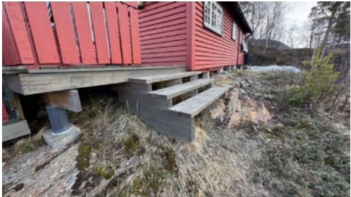
Trapper mangler rekkverk i forhold til forskriftskrav.
