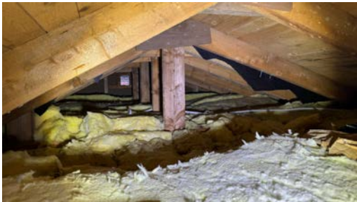
Det er registrert spor etter skadedyr/mus.
