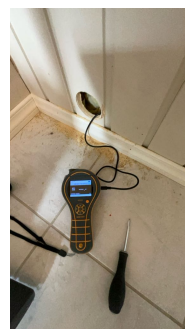
Hulltakning foretatt fra gang mot vaskerom. Ved fuktmåling ble det registrert tørre verdier.
