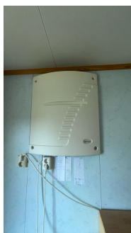
Aggregat plassert på vegg i vaskerom.
