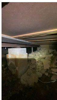
Lav høyde mellom grunnen og bjelkelag, som gir økt risiko for skader.
