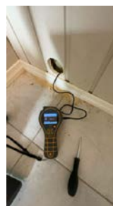
Hulltaking foretatt fra gang mot vaskerom. Ved fuktmåling ble det registrert tørre verdier.
