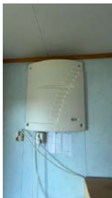
Aggregat plassert på vegg i vaskerom.
