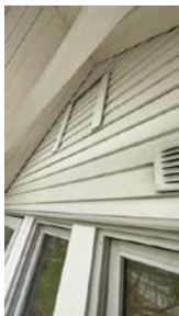
Inspeksjonsluke var fastskrudd, loft er derfor ikke inspisert.
