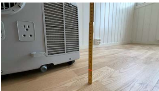
Helningsavvik på 11 mm ble målt i soverom på loft.
