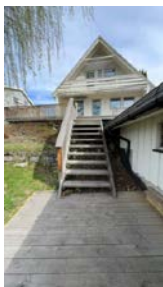
Manglende rekkverk på en side av trappen.
