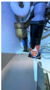
Stoppekran er plassert i kjøkkenbenk
