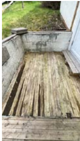
Det er værslitt/oppsprukket trevirke/trepaneler.
