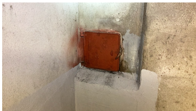
Sotluke md ødelagte hengsler
