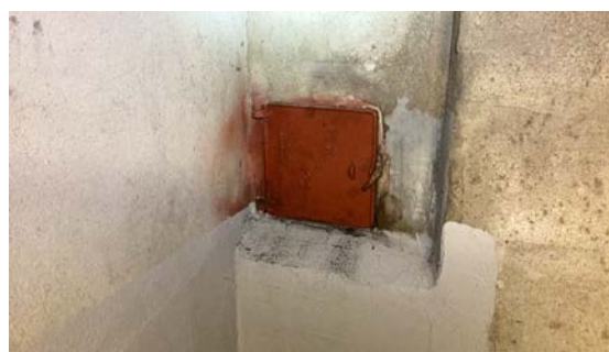
Sotluke md ødelagte hengsler
