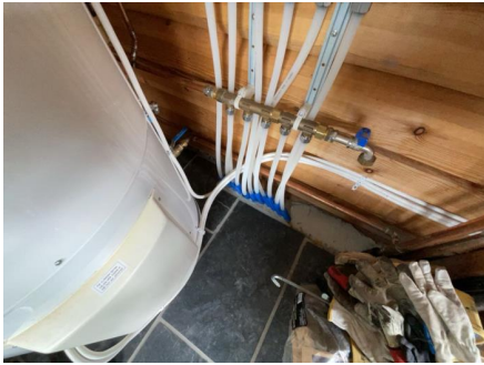
Bilde av rør i rør som er avsluttet åpent i bod/teknisk-rom
