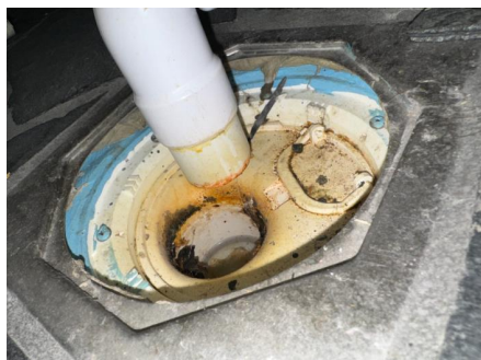
Bilde av sluk under dusjkabinett.
