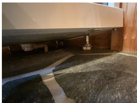
Bilde viser ingen membran i overgang gulv/vegg
