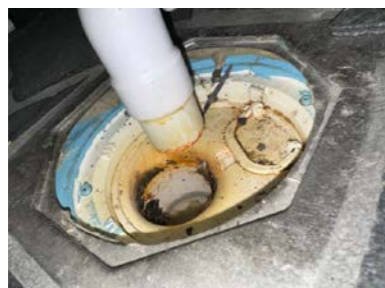
Bilde av sluk under dusjkabinett.
