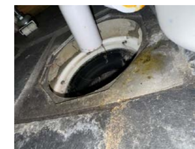
Bilde av sluk under dusjkabinett.
