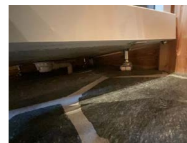
Bilde viser ingen membran i overgang gulv/vegg
