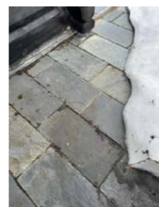
Bilde av løs skifer og krakelert fugemasse.
