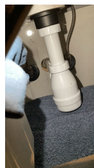
Ingen tetting rundt rør under servant.
