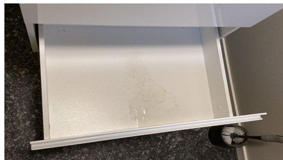
Fuktskadet under installasjon. Ingen lekkasjer ved befarings.
