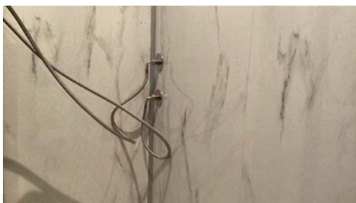
Ukjent tetting rundt vannrør.
