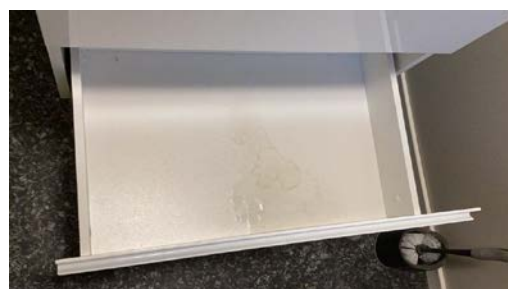
Fuktskadet under installasjon. Ingen lekkasjer ved befaring.
