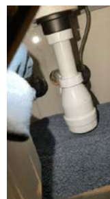
Ingen tetting rundt rør under servant.
