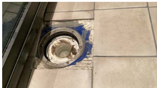
Synlig mansjett og membran, ingen slukrist.
