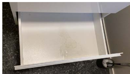
Fuktskadet under installasjon. Ingen lekkasjer ved befaring.
