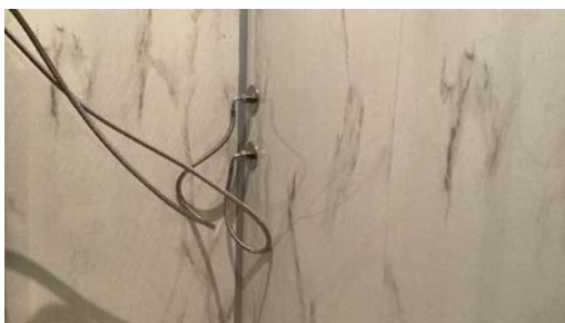
Ukjent tetting rundt vannrør.
