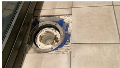
Synlig mansjett og membran, ingen slukrist.
