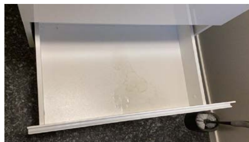
Fuktskadet under installasjon. Ingen lekkasjer ved befarig.
