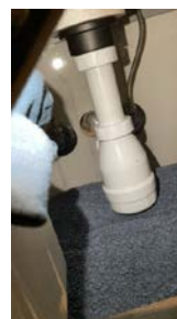
Ingen tetting rundt rør under servant.
