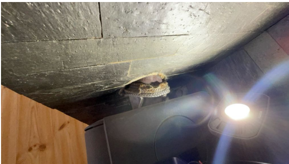
Synlig sot og løst tau rundt rørgjennomføring.
