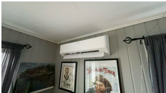
Varmepumpe, innvendig komponent.
