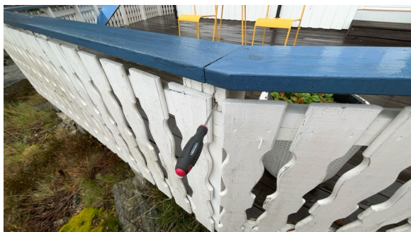
Stedvis råte i terrassekonstruksjon.
