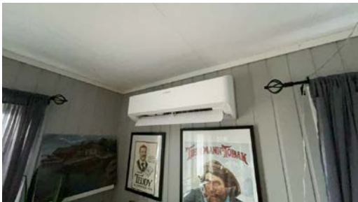
Varmepumpe, innvendig komponent.
