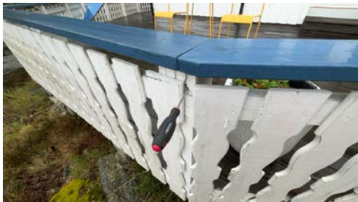
Stedvis råde i terrassekonstruksjon.
