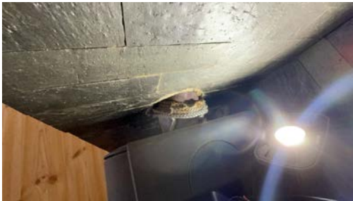
Synlig sot og løst tau rundt rørgjennomføring.
